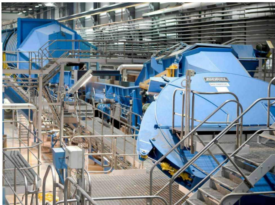
Рисунок 1.5. Линия от окорочного барабана к рубительной машине
